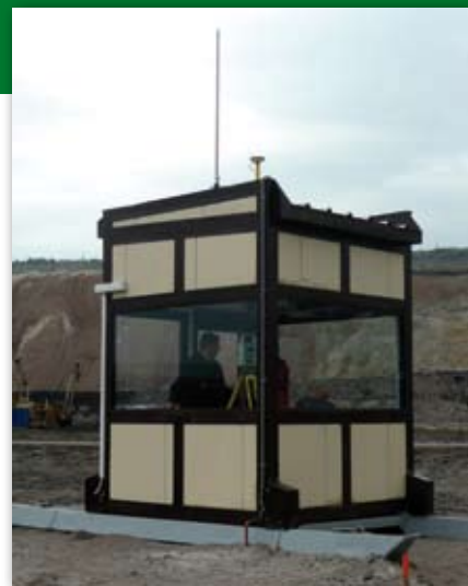
Kontener pomiarowy systemu ciągłego monitoringu deformacji wyrobisk górniczych w odkrywcze Kopalni Węgla Brunatnego „Bełchatów”
